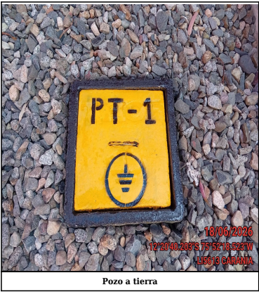
Pozo a tierra
