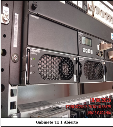
Gabinete Tx 1 Abierto
