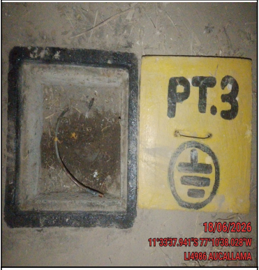
Pozo a tierra
