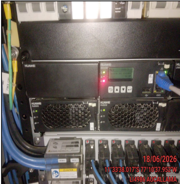
Gabinete Tx 1 Abierto
