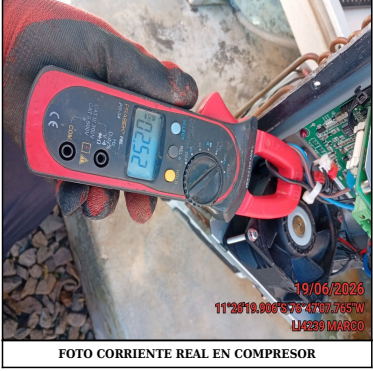
FOTO CORRIENTE REAL EN COMPRESOR
