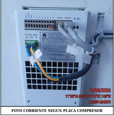
FOTO CORRIENTE SEGUN PLACA COMPRESOR
