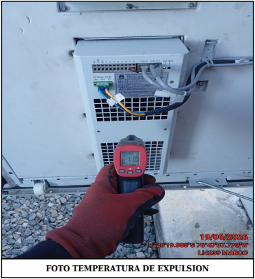
FOTO TEMPERATURA DE EXPULSION
