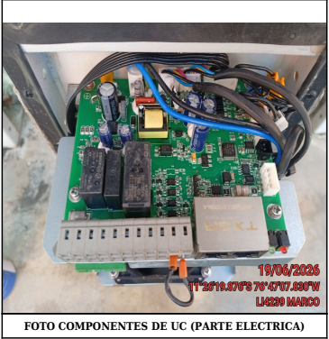
FOTO COMPONENTES DE UC (PARTE ELECTRICA)
