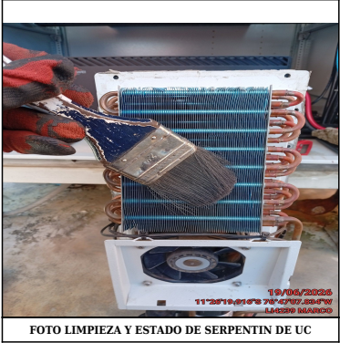
FOTO LIMPIEZA Y ESTADO DE SERPENTIN DE UC
