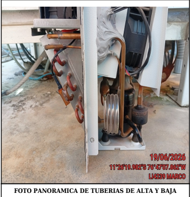
FOTO PANORAMICA DE TUBERIAS DE ALTA Y BAJA
