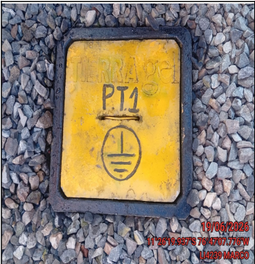
Pozo a tierra
