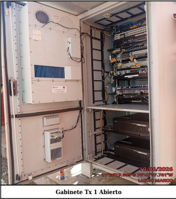
Gabinete Tx 1 Abierto
