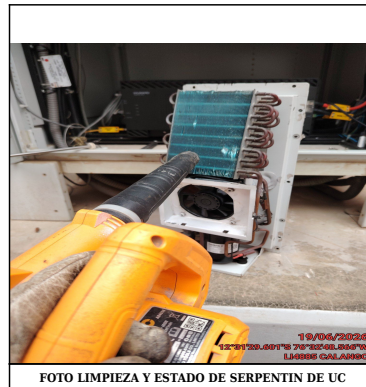
FOTO LIMPIEZA Y ESTADO DE SERPENTIN DE UC
