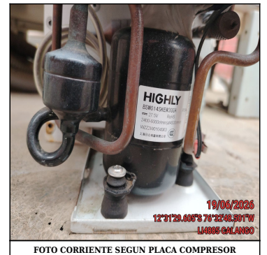
FOTO CORRIENTE SEGUN PLACA COMPRESOR
