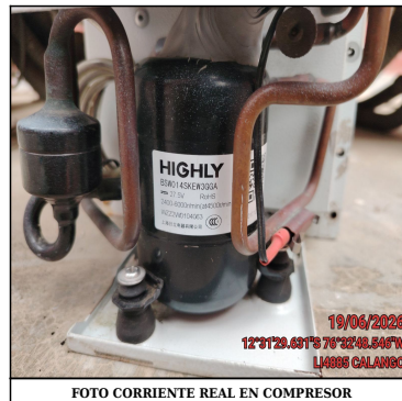
FOTO CORRIENTE REAL EN COMPRESOR
