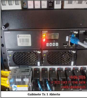
Gabinete Tx 1 Abierto
