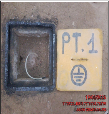
Pozo a tierra
