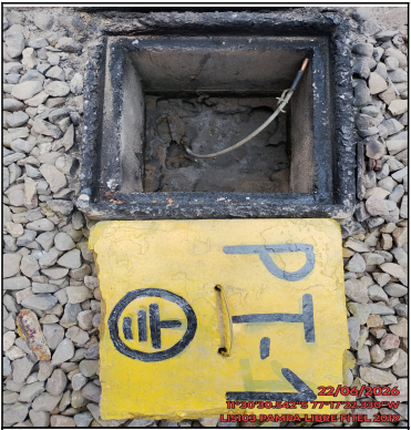
Pozo a tierra
