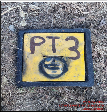
Pozo a tierra
