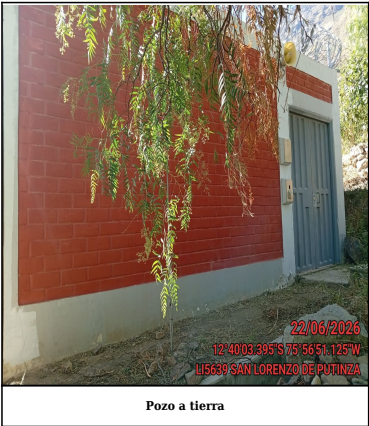
Pozo a tierra
