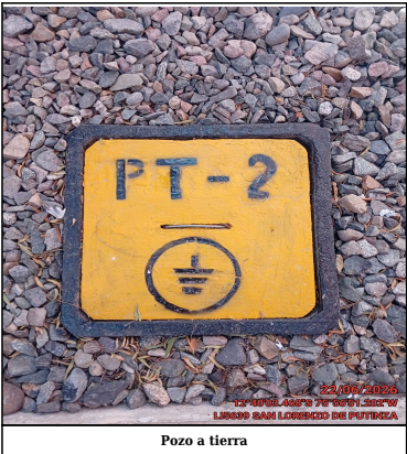
Pozo a tierra
