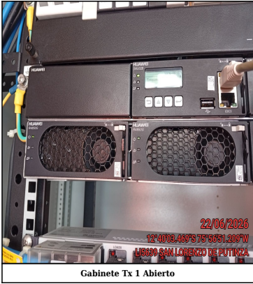
Gabinete Tx 1 Abierto
