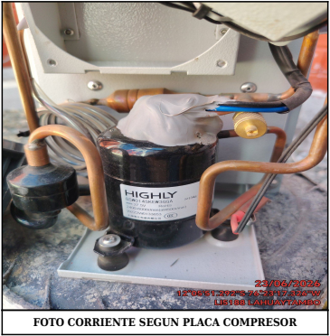
FOTO CORRIENTE SEGUN PLACA COMPRESOR
