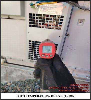
FOTO TEMPERATURA DE EXPULSION
