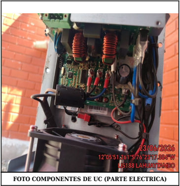
FOTO COMPONENTES DE UC (PARTE ELECTRICA)
