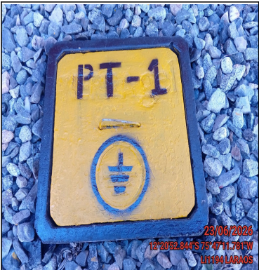
Pozo a tierra
