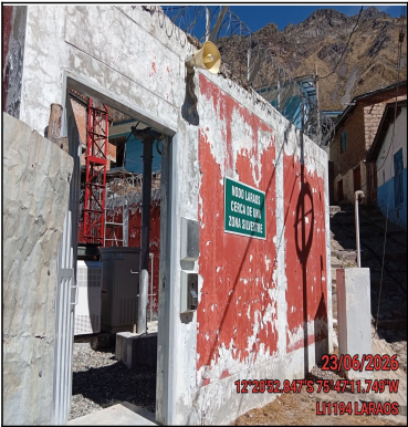
Pozo a tierra
