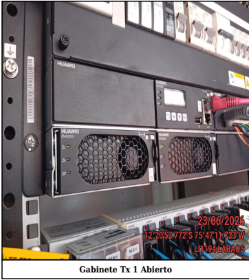
Gabinete Tx 1 Abierto
