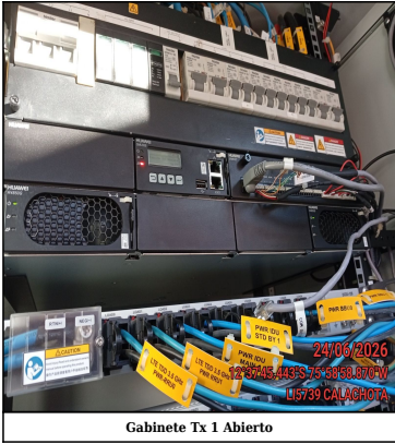
Gabinete Tx 1 Abierto
