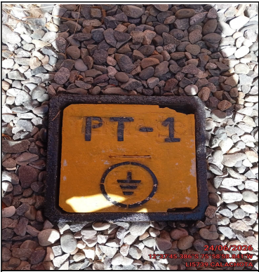
Pozo a tierra
