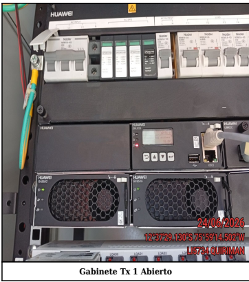
Gabinete Tx 1 Abierto
