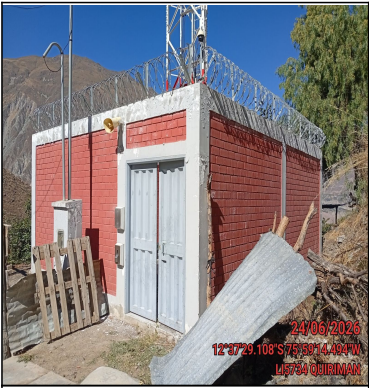
Pozo a tierra
