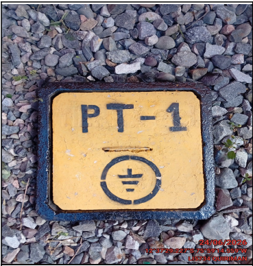
Pozo a tierra
