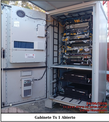
Gabinete Tx 1 Abierto
