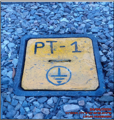
Pozo a tierra
