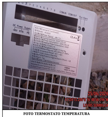
FOTO TERMOSTATO TEMPERATURA
