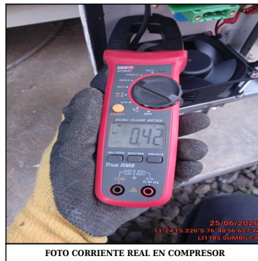
FOTO CORRIENTE REAL EN COMPRESOR
