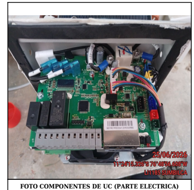
FOTO COMPONENTES DE UC (PARTE ELECTRICA)
