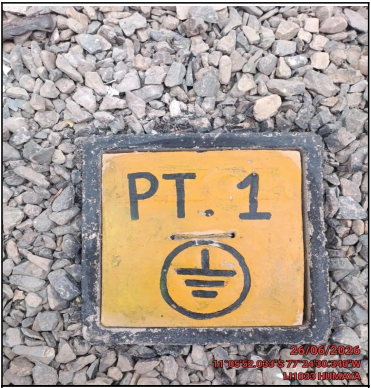
Pozo a tierra
