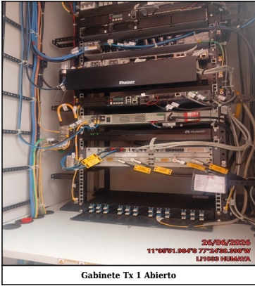
Gabinete Tx 1 Abierto
