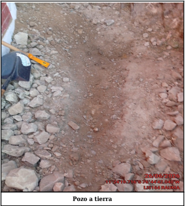
Pozo a tierra
