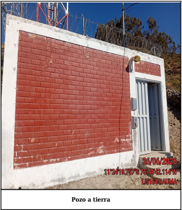
Pozo a tierra
