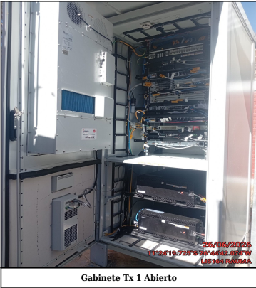
Gabinete Tx 1 Abierto
