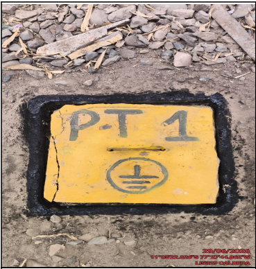
Pozo a tierra
