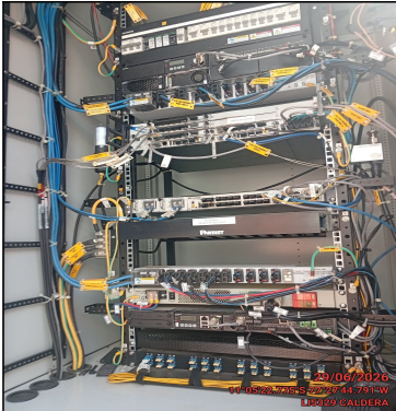
Gabinete Tx 1 Abierto
