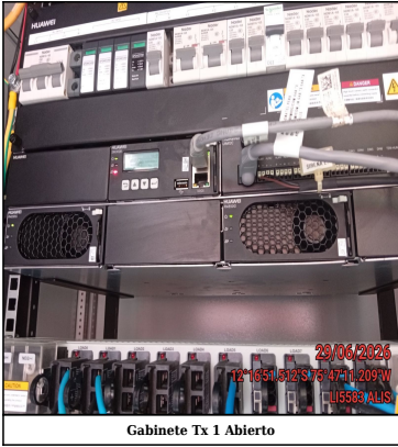
Gabinete Tx 1 Abierto
