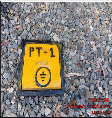
Pozo a tierra
