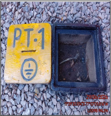
Pozo a tierra
