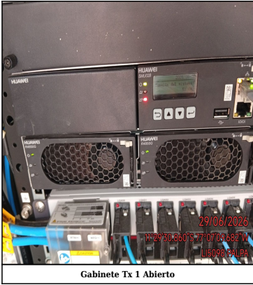
Gabinete Tx 1 Abierto
