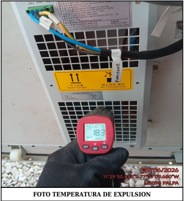
FOTO TEMPERATURA DE EXPULSION
