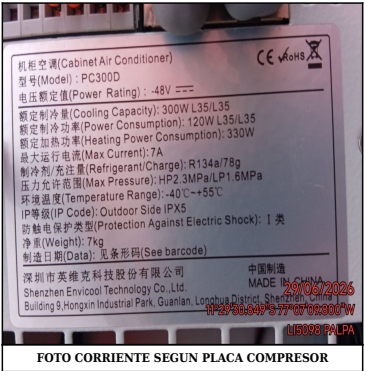
FOTO CORRIENTE SEGUN PLACA COMPRESOR
