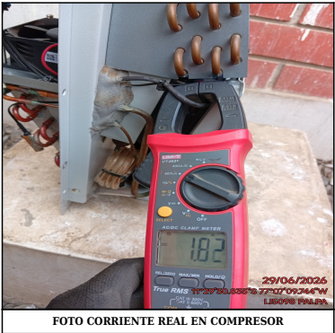
FOTO CORRIENTE REAL EN COMPRESOR
