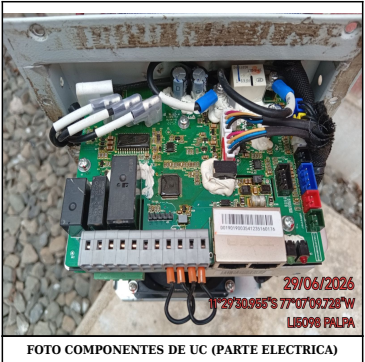
FOTO COMPONENTES DE UC (PARTE ELECTRICA)
