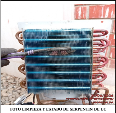
FOTO LIMPIEZA Y ESTADO DE SERPENTIN DE UC
