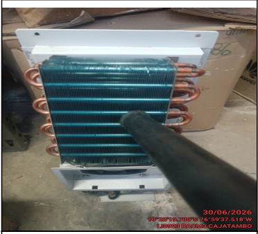
FOTO LIMPIEZA Y ESTADO DE SERPENTIN DE UC
