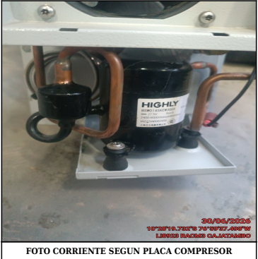
FOTO CORRIENTE SEGUN PLACA COMPRESOR
