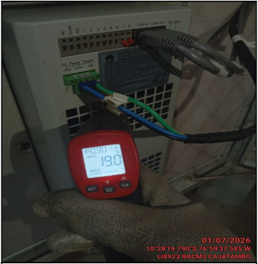
FOTO TEMPERATURA DE EXPULSION
