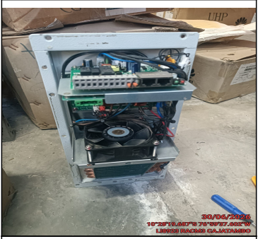
FOTO COMPONENTES DE UC (PARTE ELECTRICA)
