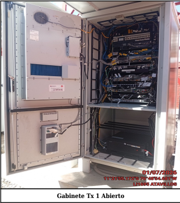
Gabinete Tx 1 Abierto
