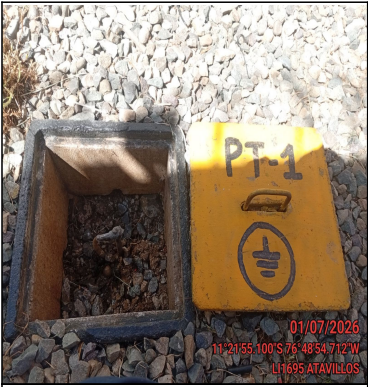
Pozo a tierra
