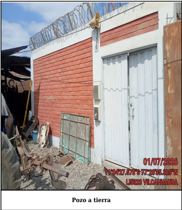
Pozo a tierra
