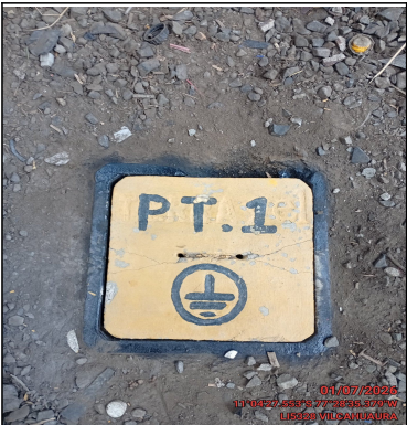
Pozo a tierra
