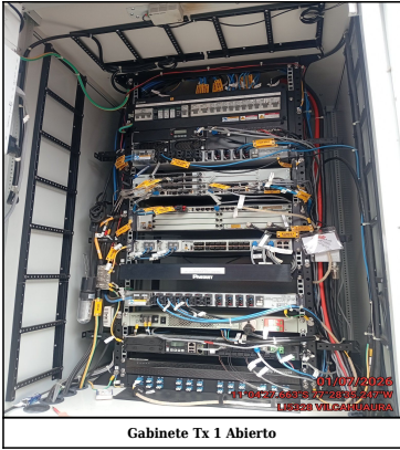
Gabinete Tx 1 Abierto
