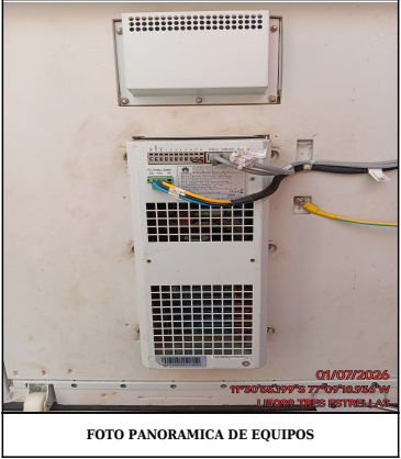
FOTO PANORAMICA DE EQUIPOS
