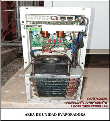
AREA DE UNIDAD EVAPORADORA
