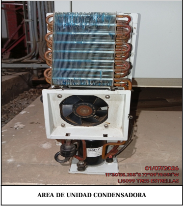
AREA DE UNIDAD CONDENSADORA
