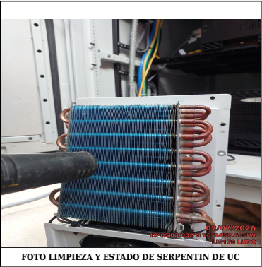
FOTO LIMPIEZA Y ESTADO DE SERPENTIN DE UC
