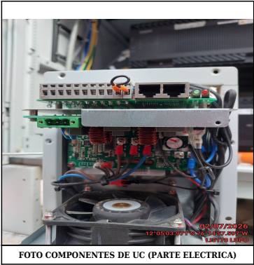
FOTO COMPONENTES DE UC (PARTE ELECTRICA)
