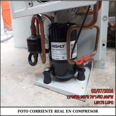
FOTO CORRIENTE REAL EN COMPRESOR
