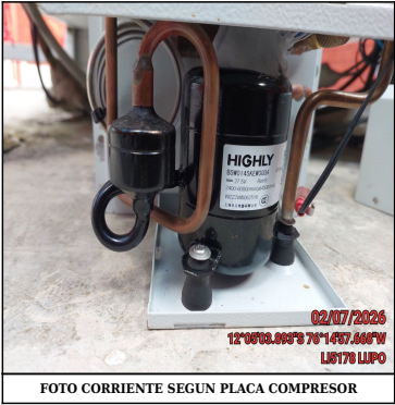
FOTO CORRIENTE SEGUN PLACA COMPRESOR
