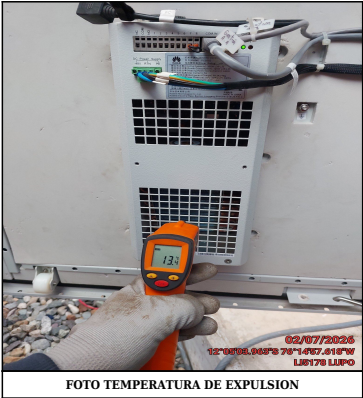
FOTO TEMPERATURA DE EXPULSION
