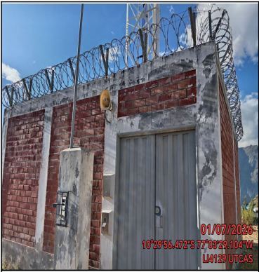
Pozo a tierra
