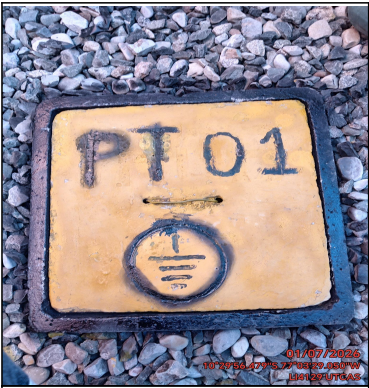
Pozo a tierra
