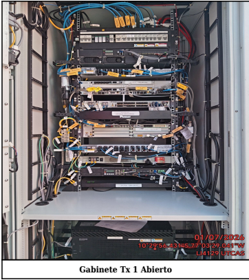
Gabinete Tx 1 Abierto
