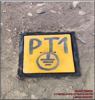
Pozo a tierra
