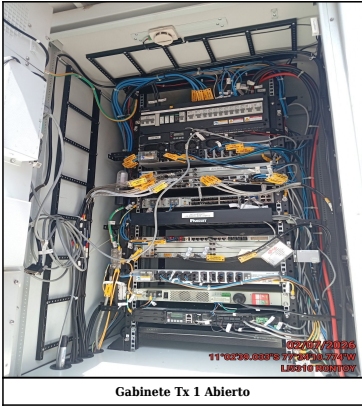
Gabinete Tx 1 Abierto
