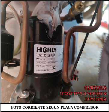
FOTO CORRIENTE SEGUN PLACA COMPRESOR
