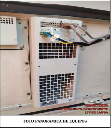
FOTO PANORAMICA DE EQUIPOS
