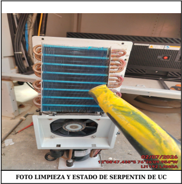
FOTO LIMPIEZA Y ESTADO DE SERPENTIN DE UC
