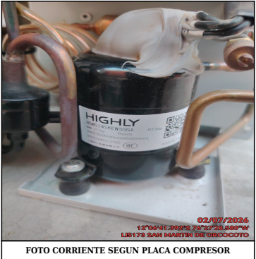
FOTO CORRIENTE SEGUN PLACA COMPRESOR
