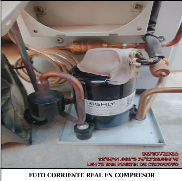
FOTO CORRIENTE REAL EN COMPRESOR
