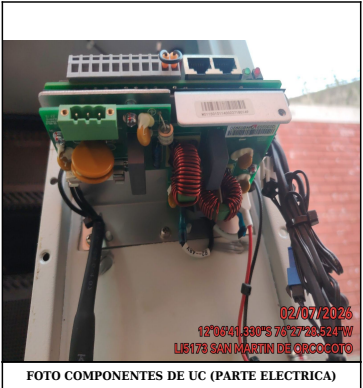
FOTO COMPONENTES DE UC (PARTE ELECTRICA)
