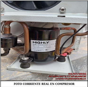
FOTO CORRIENTE REAL EN COMPRESOR
