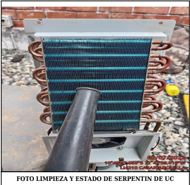
FOTO LIMPIEZA Y ESTADO DE SERPENTIN DE UC
