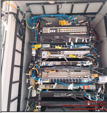
Gabinete Tx 1 Abierto
