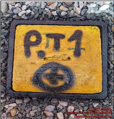
Pozo a tierra
