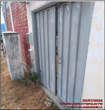
Pozo a tierra
