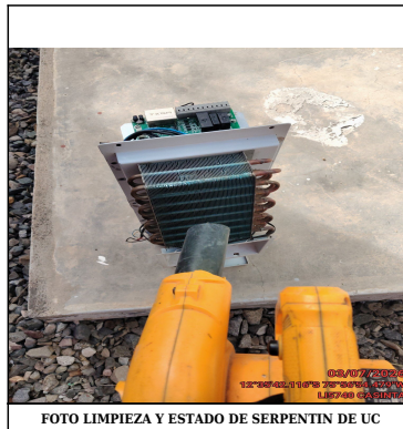
FOTO LIMPIEZA Y ESTADO DE SERPENTIN DE UC
