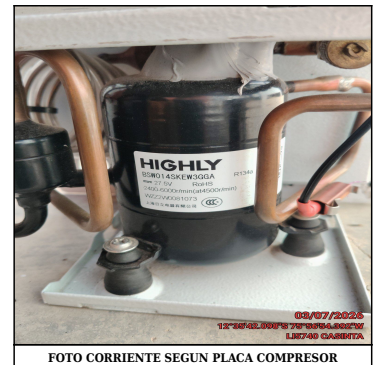
FOTO CORRIENTE SEGUN PLACA COMPRESOR
