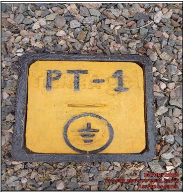
Pozo a tierra
