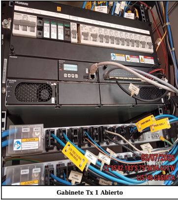
Gabinete Tx 1 Abierto
