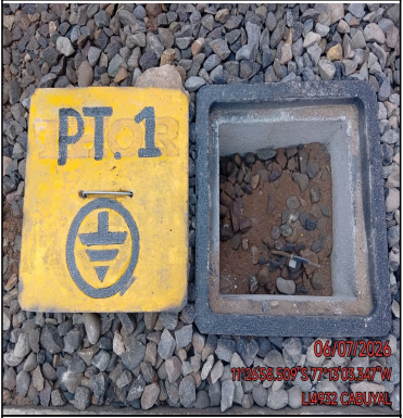
Pozo a tierra
