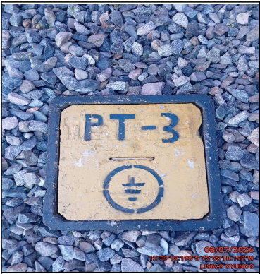
Pozo a tierra
