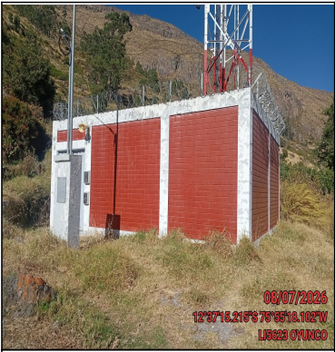
Pozo a tierra
