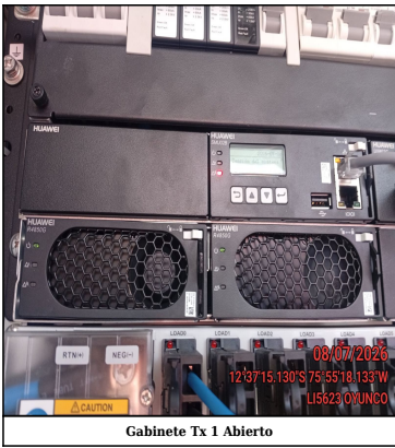
Gabinete Tx 1 Abierto
