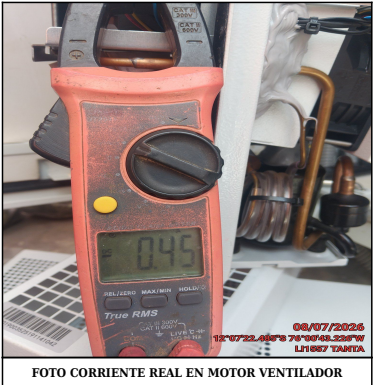
FOTO CORRIENTE REAL EN MOTOR VENTILADOR
