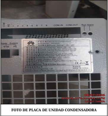
FOTO DE PLACA DE UNIDAD CONDENSADORA
