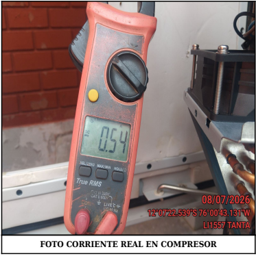
FOTO CORRIENTE REAL EN COMPRESOR
