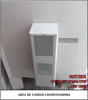
AREA DE UNIDAD CONDENSADORA
