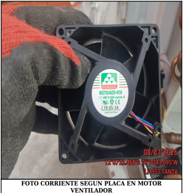
FOTO CORRIENTE SEGUN PLACA EN MOTOR VENTILADOR
