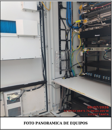
FOTO PANORAMICA DE EQUIPOS
