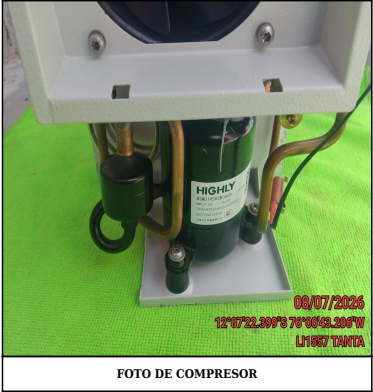
FOTO DE COMPRESOR
