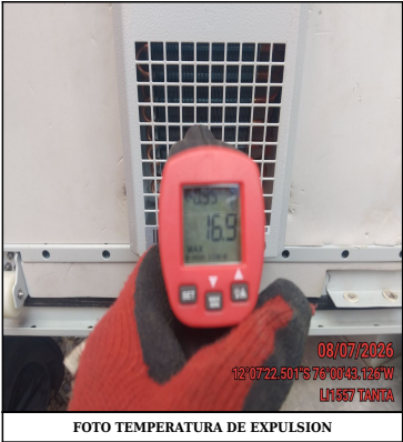
FOTO TEMPERATURA DE EXPULSION
