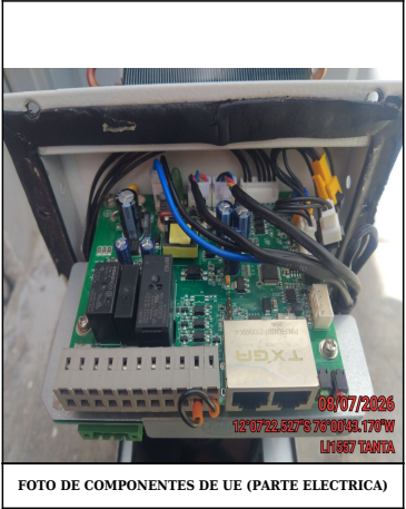
FOTO DE COMPONENTES DE UE (PARTE ELECTRICA)
