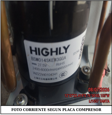
FOTO CORRIENTE SEGUN PLACA COMPRESOR
