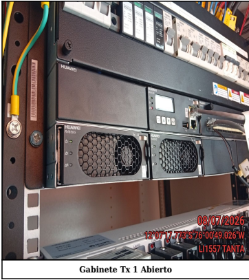
Gabinete Tx 1 Abierto
