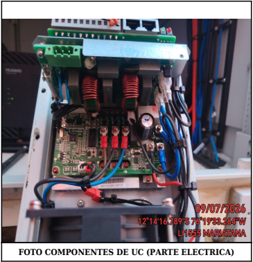
FOTO COMPONENTES DE UC (PARTE ELECTRICA)
