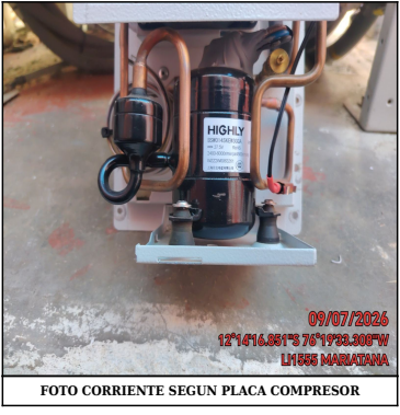
FOTO CORRIENTE SEGUN PLACA COMPRESOR
