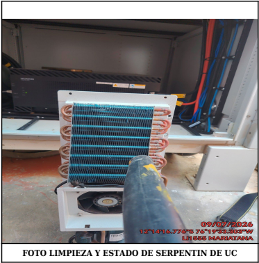
FOTO LIMPIEZA Y ESTADO DE SERPENTIN DE UC
