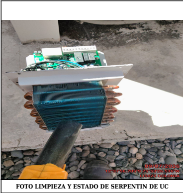
FOTO LIMPIEZA Y ESTADO DE SERPENTIN DE UC
