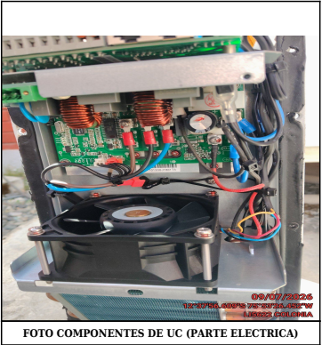
FOTO COMPONENTES DE UC (PARTE ELECTRICA)
