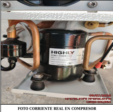
FOTO CORRIENTE REAL EN COMPRESOR
