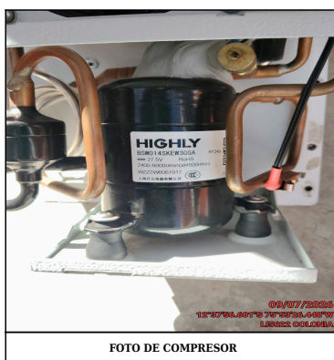
FOTO DE COMPRESOR
