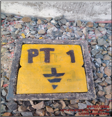
Pozo a tierra
