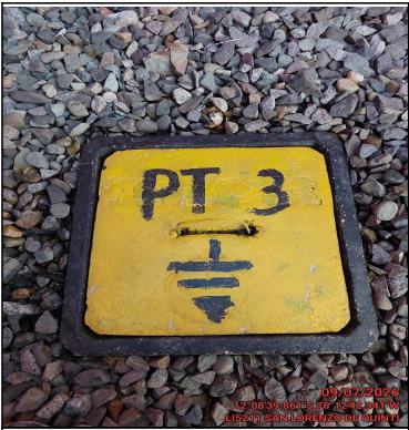
Pozo a tierra
