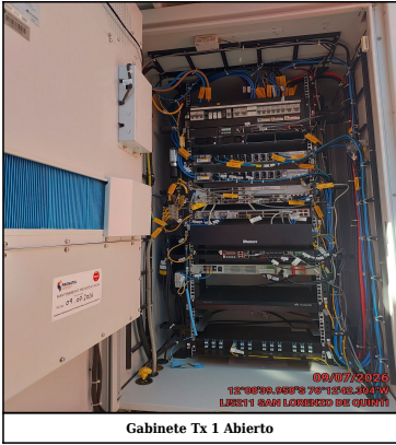
Gabinete Tx 1 Abierto
