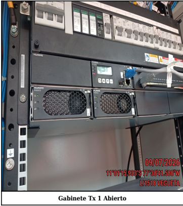
Gabinete Tx 1 Abierto
