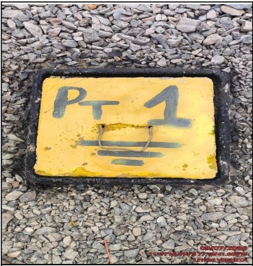
Pozo a tierra
