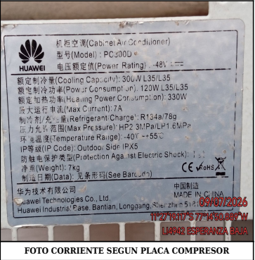
FOTO CORRIENTE SEGUN PLACA COMPRESOR
