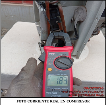
FOTO CORRIENTE REAL EN COMPRESOR
