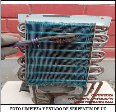
FOTO LIMPIEZA Y ESTADO DE SERPENTIN DE UC
