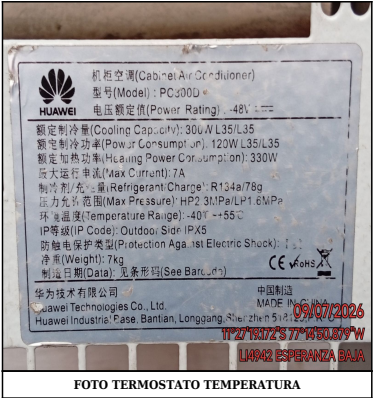
FOTO TERMOSTATO TEMPERATURA
