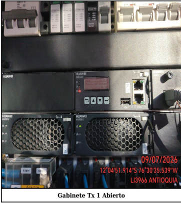
Gabinete Tx 1 Abierto
