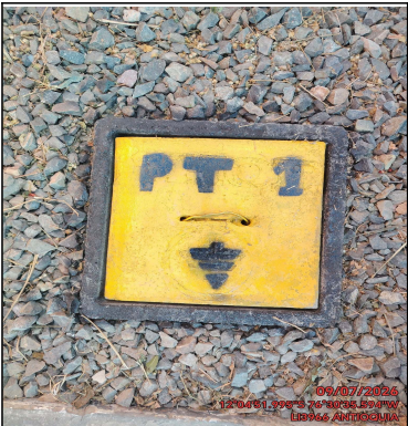
Pozo a tierra
