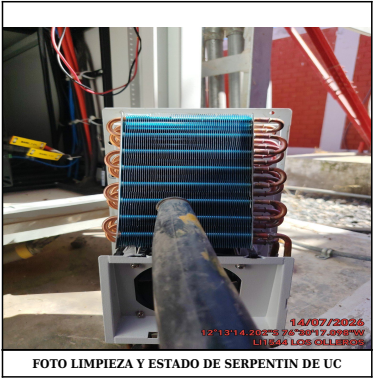
FOTO LIMPIEZA Y ESTADO DE SERPENTIN DE UC
