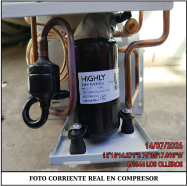
FOTO CORRIENTE REAL EN COMPRESOR
