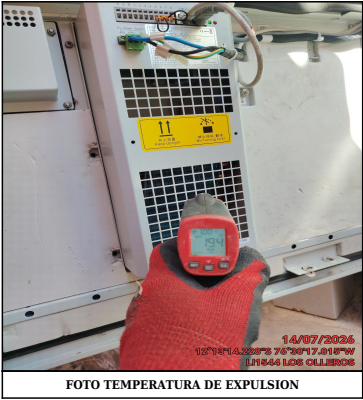
FOTO TEMPERATURA DE EXPULSION
