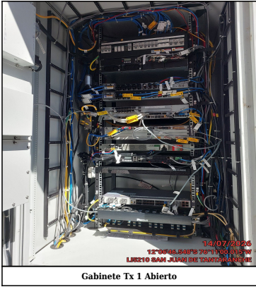
Gabinete Tx 1 Abierto
