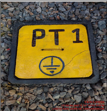
Pozo a tierra
