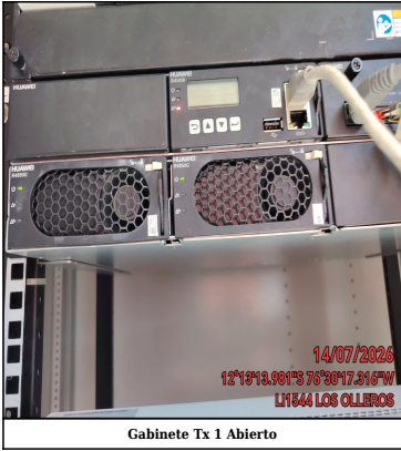
Gabinete Tx 1 Abierto
