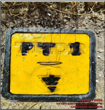
Pozo a tierra
