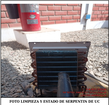
FOTO LIMPIEZA Y ESTADO DE SERPENTIN DE UC
