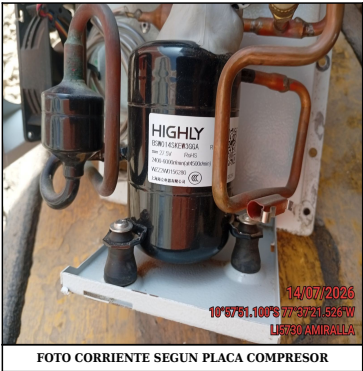
FOTO CORRIENTE SEGUN PLACA COMPRESOR
