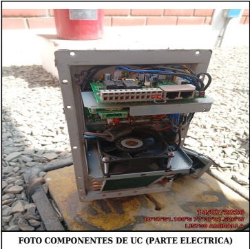
FOTO COMPONENTES DE UC (PARTE ELECTRICA)
