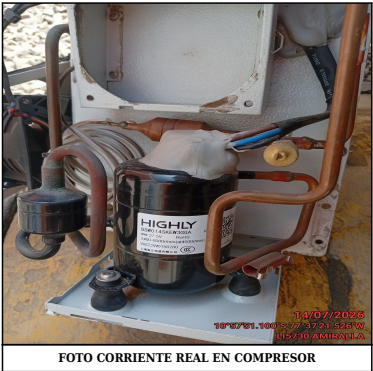
FOTO CORRIENTE REAL EN COMPRESOR
