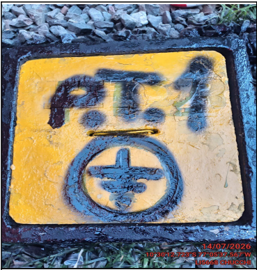
Pozo a tierra
