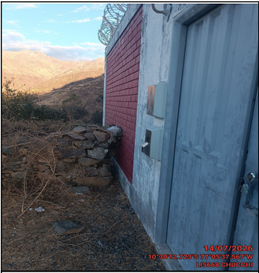
Pozo a tierra
